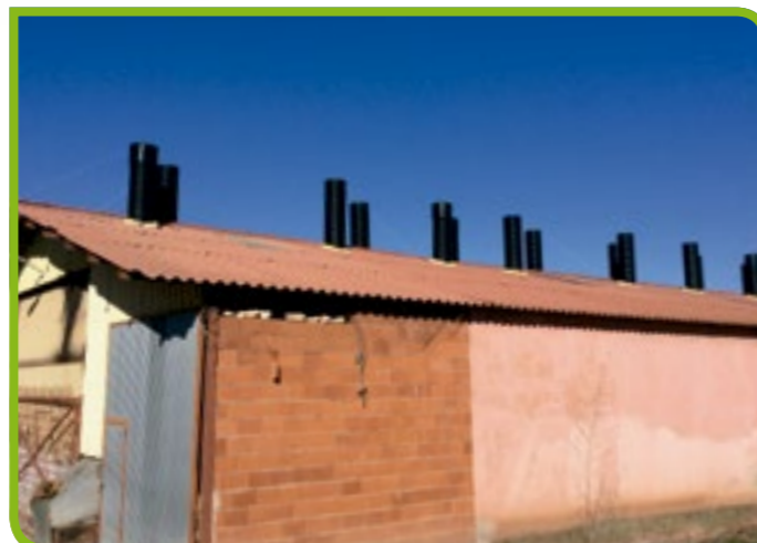
Chimeneas de ventilación.
