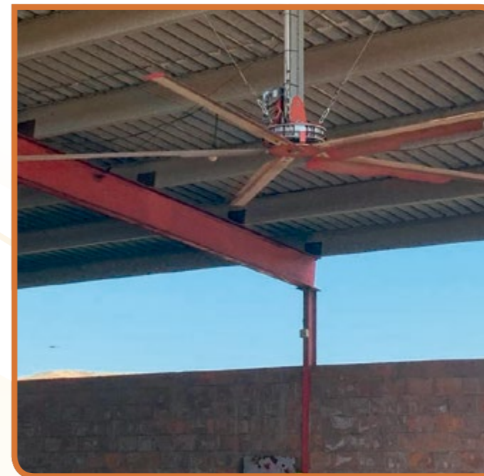
Naves con ventiladores.
